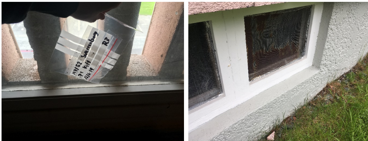
Figur 5: Vinduer med kitt er ordinært avfall
