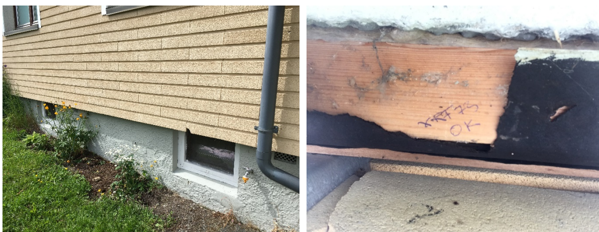
Figur 13: Lekter under betongsteinskledning er ikke CCA-impregnert
